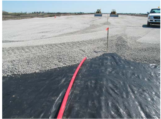
Conduit for Centerline Lights
